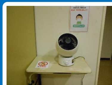
ロッカー内の換気
